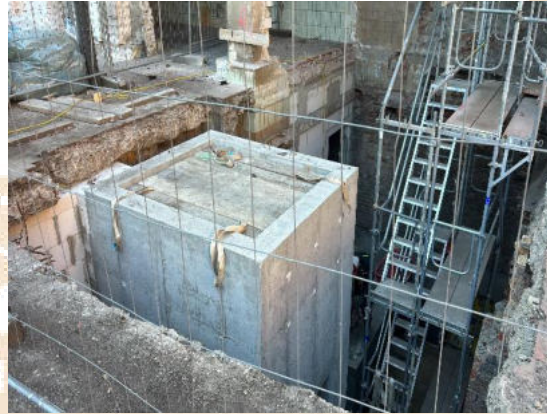
der Aufzug ist am Erdgeschoss angekommen
